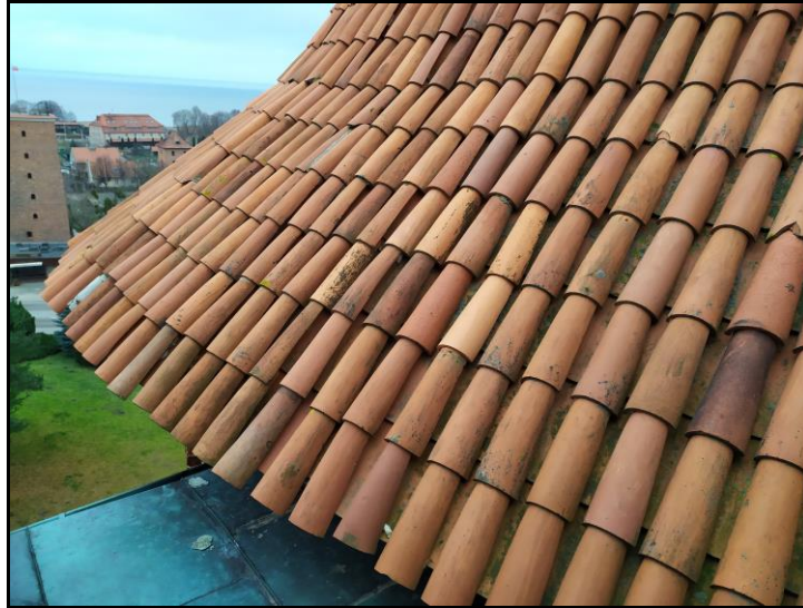
Fot.9 Pokrycie dachowe- baszta zanieczyszczona i miejscowo uszkodzone dachówki
