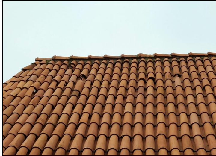
Fot. 10 Połączenie zachodnia baszt- uszkodzenia dachówek
