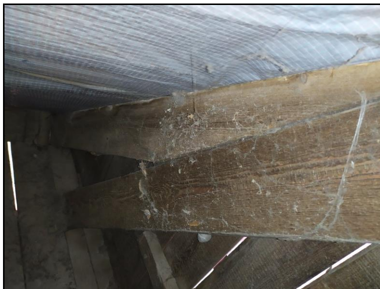
Fot. 14 Krokiew i przypustnica- powierzchniowe zawilgocenia
