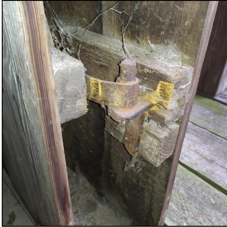
Fot. 20 Skorodowany zawias drzewiowy- drzwi w ścianie deskowej południowej
