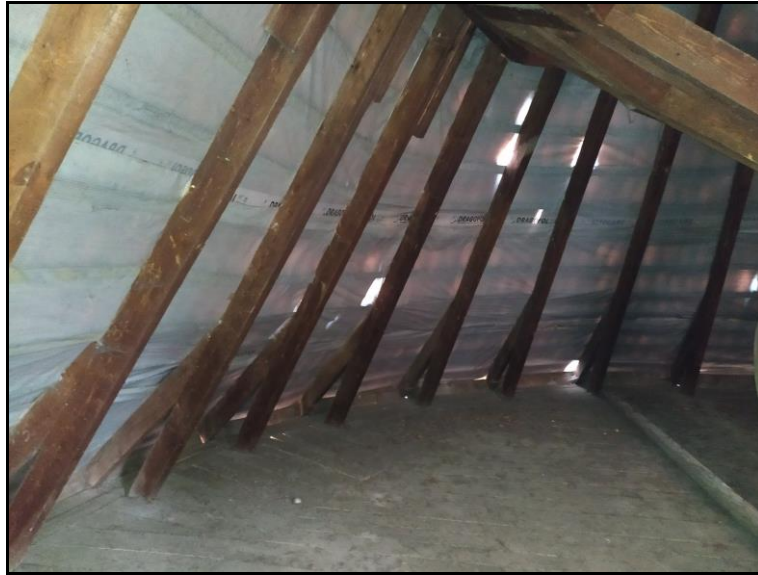
Fot. 12 Widok więźby dachowej- dostateczny stan zachowania, za folią widoczne miejsca ubytków dachówki
