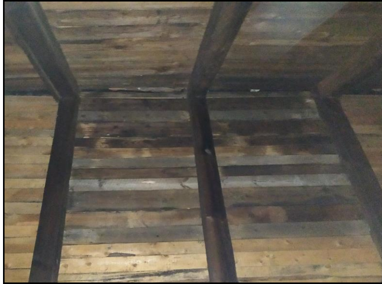
Fot. 23 Widok odeskowania połaci- widoczne zawilgocenia i korozja desek
