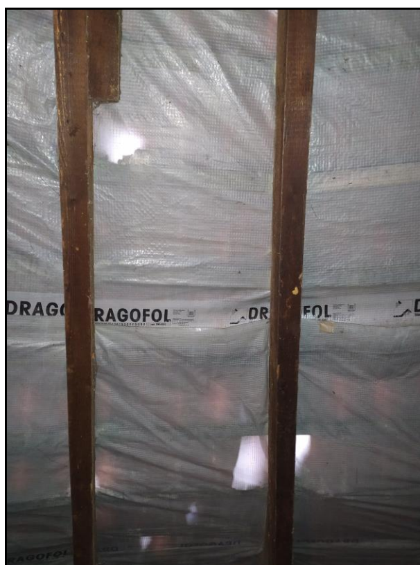
Fot. 16 Widoczna zapadająca się pod ciężarek pokrycia folia oraz miejsca ubytków dachówki
