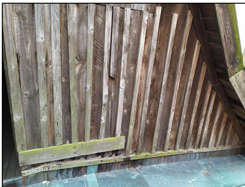
Fot. 32 Skorodowane odeskowanie szczytu
