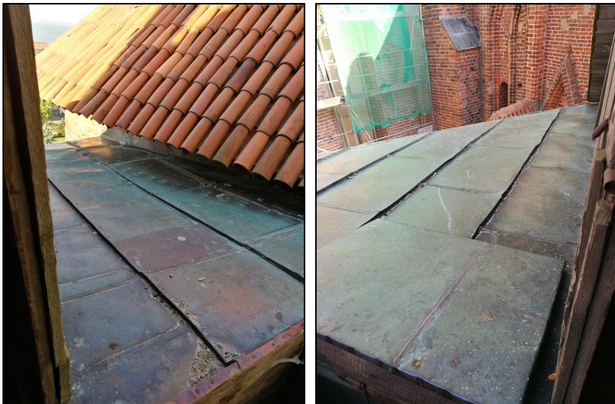
Fot. 29,30 Stropodach- skorodowane pokrycie z blachy
