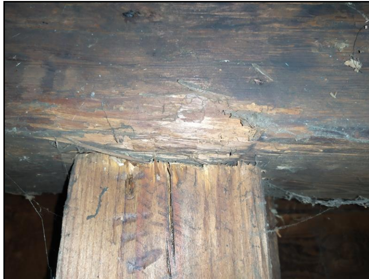
Fot. 24 Powierzchniowa korozja płatwi po stronie północnej
