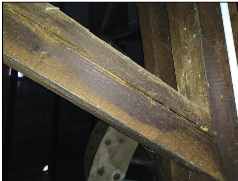
Fot.13 Spękanie zastrzału przy słupie środkowym
