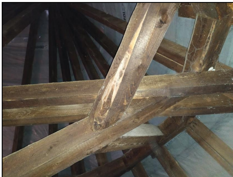
Fot. 15 Powierzchniowa korozja drewna- stan zachowania dostateczny
