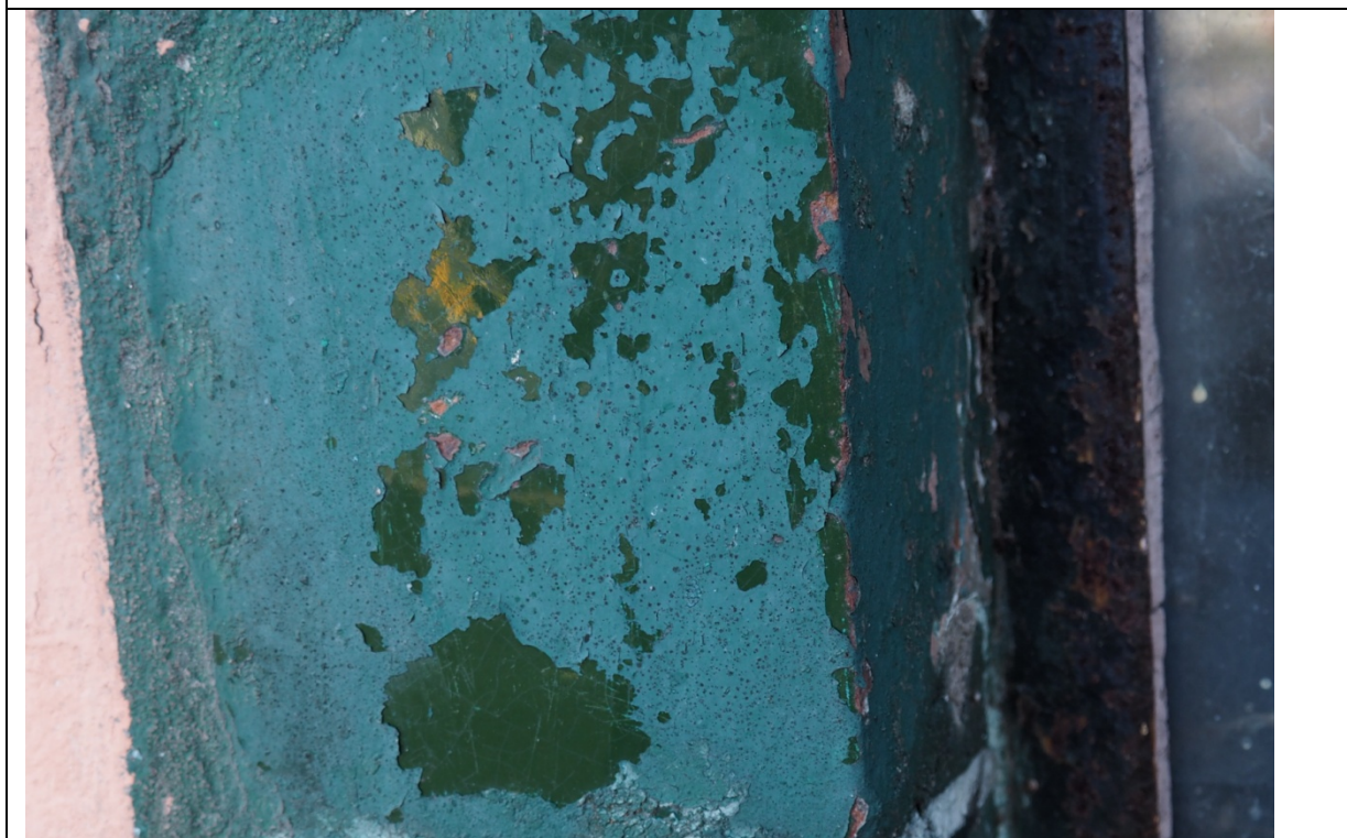
Fot. nr 15. Kaplica św. Jerzego. Zbliżenie powierzchni obramienia, Pod łuszczącą się niebieską
