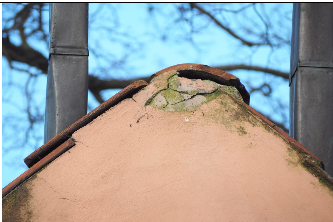
Fot. nr 5. Kaplica św. Jerzego. Zniszczenia na szczycie elewacji południowej.
