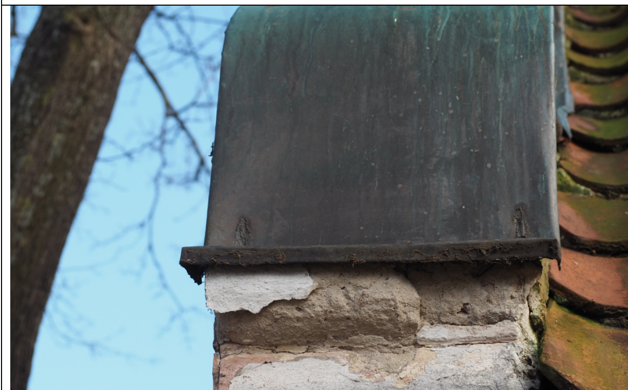
Fot. nr 7. Kaplica św. Jerzego. Zniszczenia historycznego tynku na zwieńczeniu elewacji północnej.
