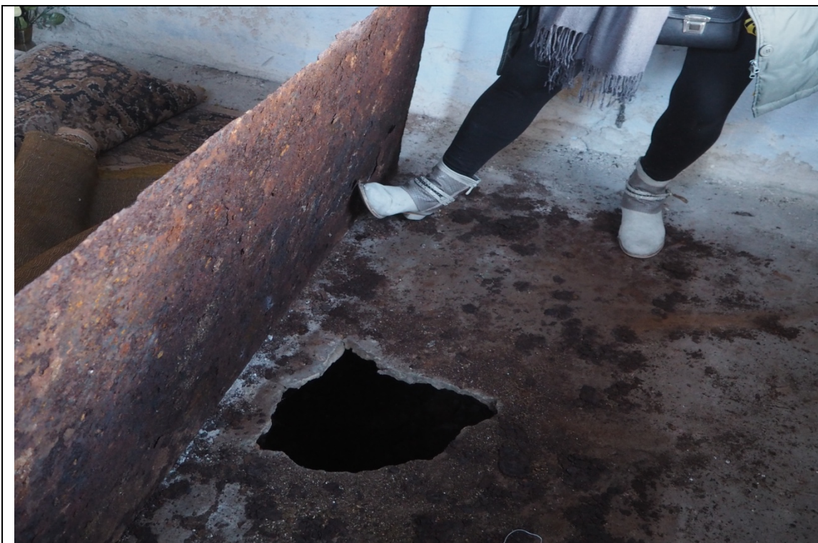
Fot. nr 21. Kaplica św. Jerzego. Posadzka betonowa z ubytkiem, przez który widać pustkę.
