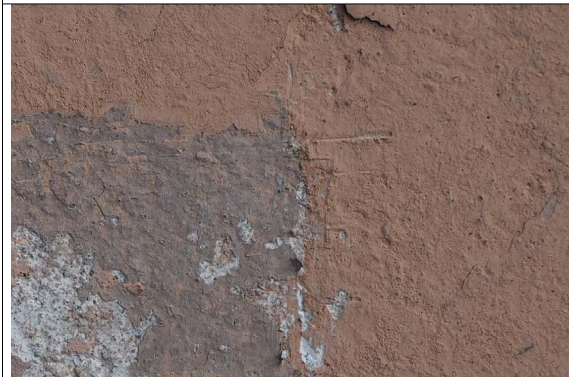
Fot. nr 13. Kaplica św. Jerzego. Zbliżenie w miejscu ubytku ukazuje szarą warstwę farby,
